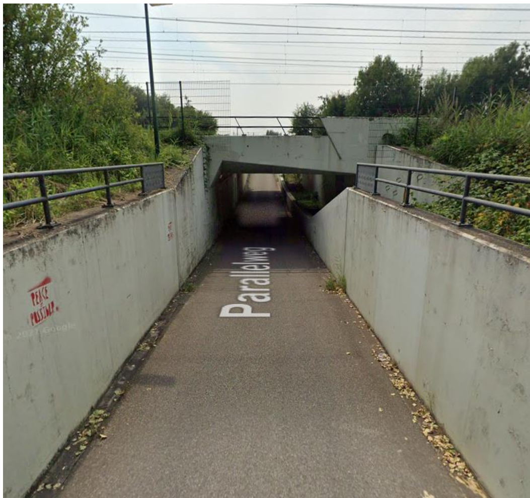
Afbeelding 5.30 Zoeklocatie IX - Spoorviaduct Parallelweg
