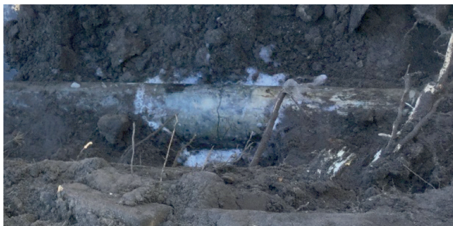
Gescheurde AC leiding als gevolg van de aanleg van een gestuurde boring.
